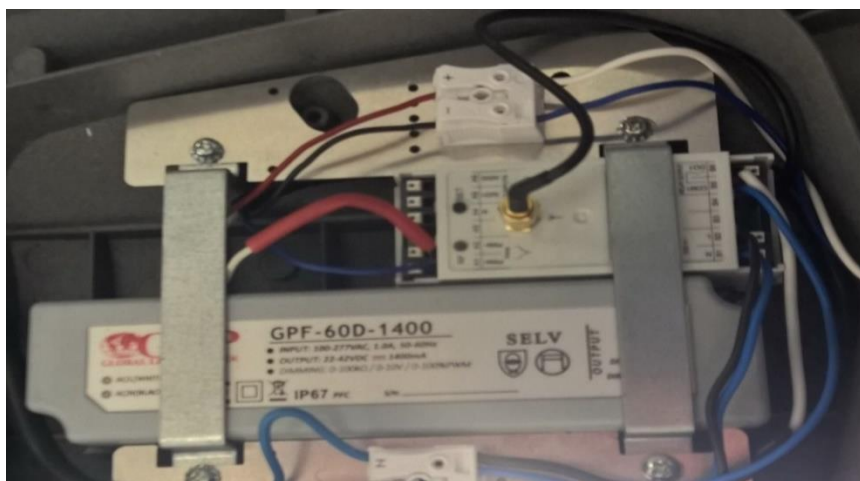
Obrázek 25 Elektrická výzbroj LED svítidla veřejného osvětlení, které je vybaveno regulovatelným driverem a přijímačem Wi-Fi. Volitelně lze vybavit senzorem přítomnosti nebo bezdrátovou kamerou včetně akumulátoru (foto: vlastní)
